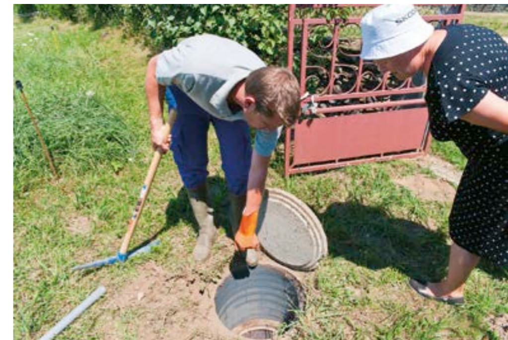
Le contrôle du bon fonctionnement des installations est effectué périodiquement via une visite sur place.
